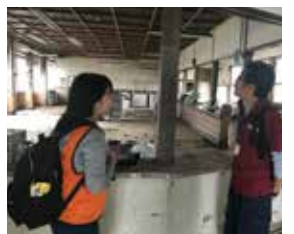
被害を受けた事務所の様子
